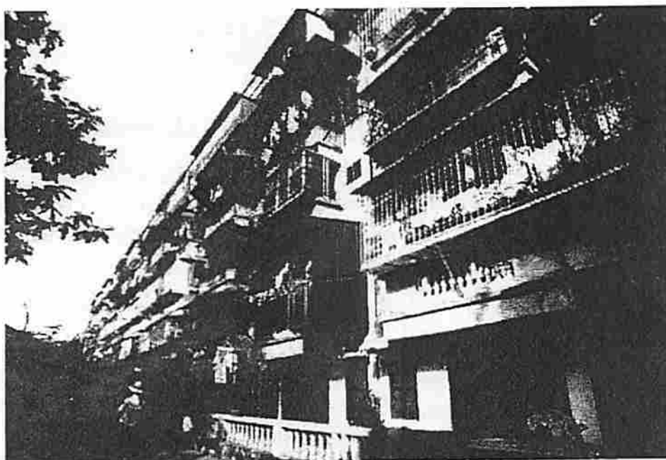
Hình ảnh: “Chuồng cọp” ngăn lối thoát nạn tại các khu tập thể cũ.
